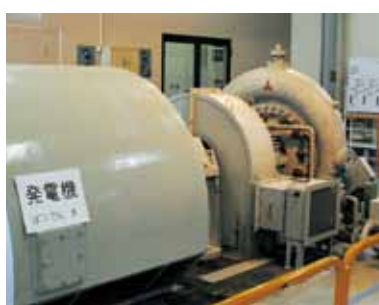
昭和29年に設置された水車・発電機
